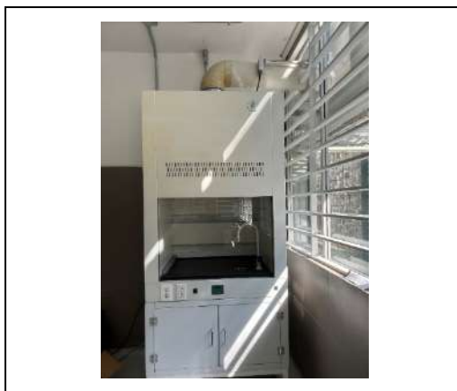
Figura 3. Campana de extracción de gases.
