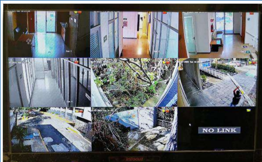
NVR HIKVISION 16 CANALES. MONITOREA EDIFICIO ANEXO
