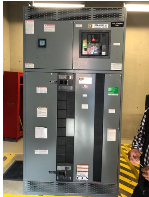
Nuevo tablero en subestación de media tensión
