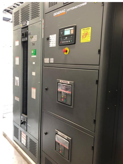
Nuevo tablero de transferencia
