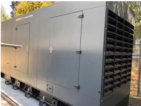
Nueva Planta de emergencia
