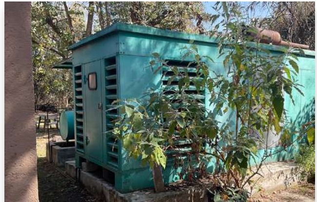
Instalación de un nuevo módulo de control y protección para la planta eléctrica de emergencia del Jardín Botánico.
